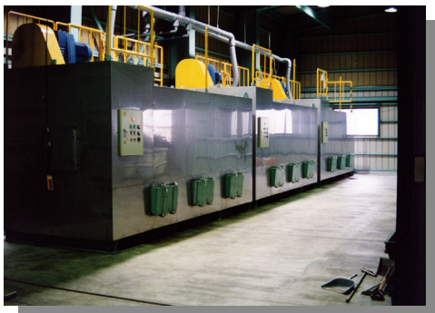
自社生ごみ堆肥化工場
